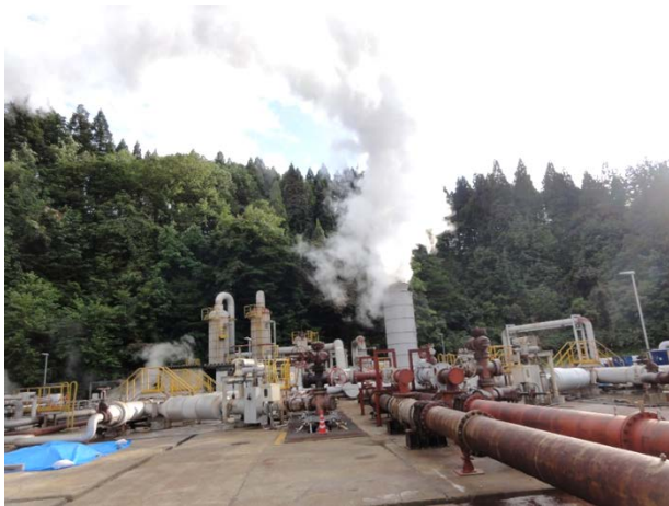
上の岱地熱発電所の生産井
