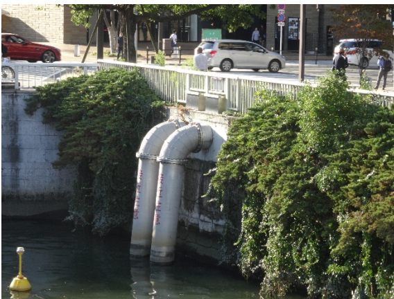
河川水取水管
