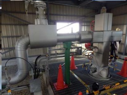
左：萌別層圧入井 右：滝ノ上層圧入井
