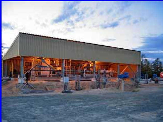
ブロックバルブおよびメーターステーション
