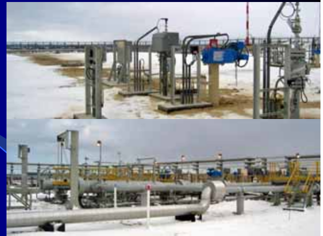
Chayvo井戸元設備およびビッグランチャー
