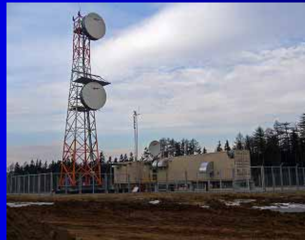
通信タワーおよび発電ユニット
