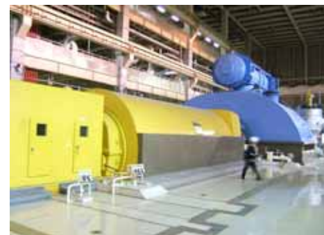
タービン 発電機（新 2 号機）
