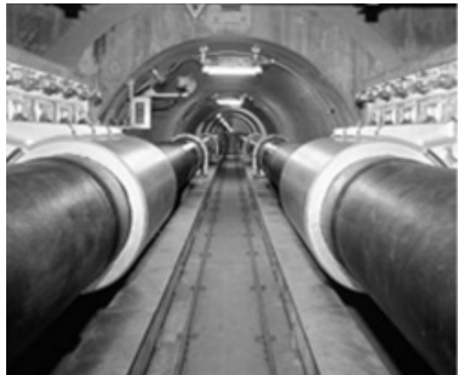
写真2 シールド内天然ガスパイプライン (出典：新日鉄エンジニアリング(株))
