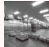
冷凍冷蔵庫 定温倉庫 防爆冷蔵庫
