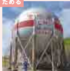
液化水素貯蔵タンク
