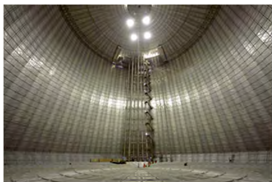
LNG 地下タンク内部
