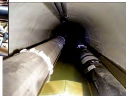
推進管内浮遊状況
