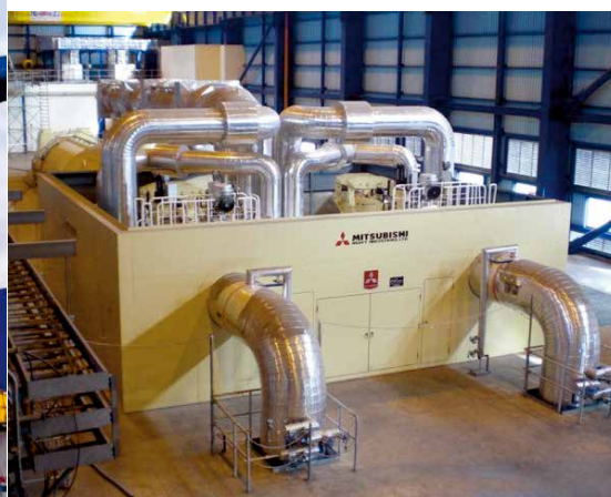
蒸気タービン
