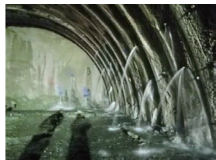
トンネル掘削後の壁面からの湧水状況
