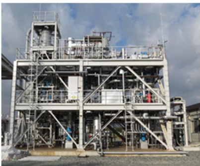
東側から撮影－ガス化炉設備
