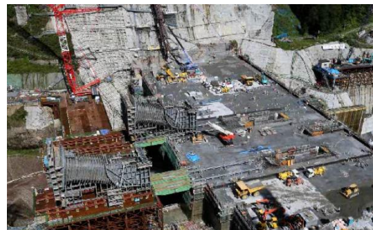
常用洪水吐放流設備の一体化引込み
