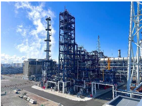
国産 SAF 製造設備
