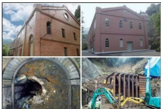
地震被害状況と復旧後の写真
