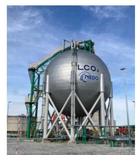
液化 CO 2 貯槽
