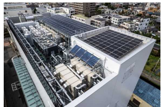
【環境・省エネ設備を集約した屋上】
