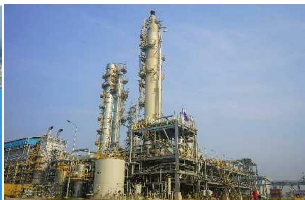
CO2 回収装置*
