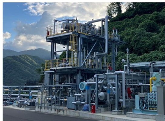
CO 2 液化設備
