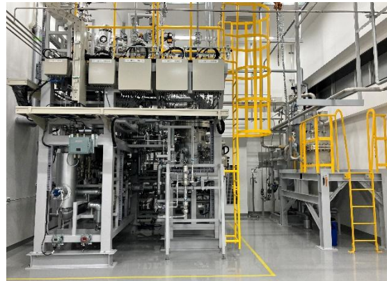
200L ガス循環発酵槽外観
