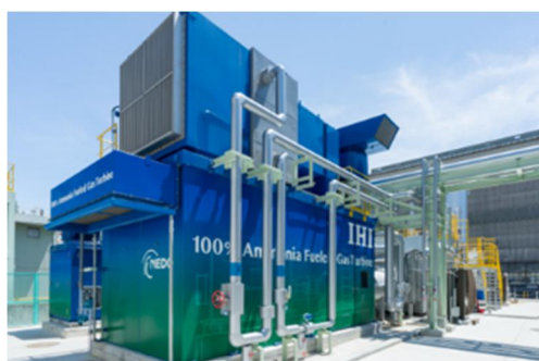
自社工場に設置したアンモニア専焼 ガスタービンコージェネレーションシステム
