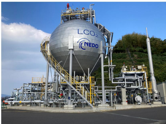
液化 CO 2 貯槽
