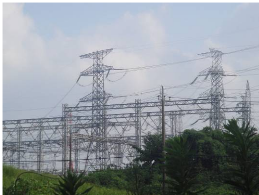
図 2.2-4 新京葉変電所
