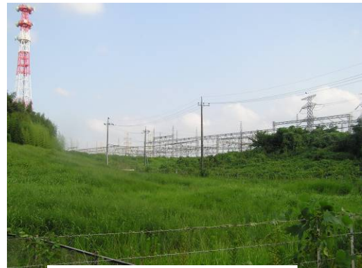
図 2.2-3 新京葉変電所
