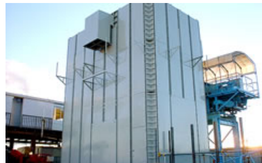
写真 5.2.2-4 超低周波用防音ハウス例
