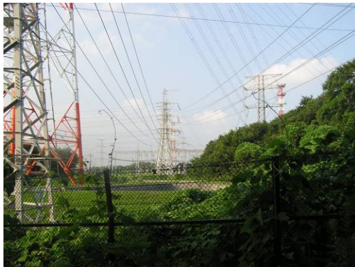
図 2.2-2 新京葉変電所
