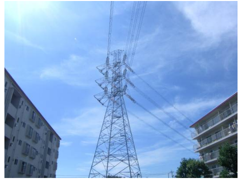
図 2.4-2 集合住宅内架空送電
