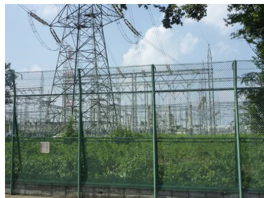
図 2.2-8 新所沢変電所
