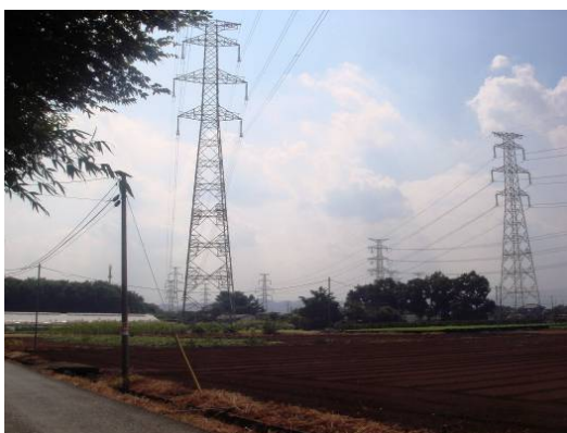
図 2.2-9 新所沢～中東京変電所間 架空送電線
