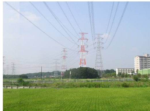
図 2.2-5 新京葉変電所からの架空送電線
