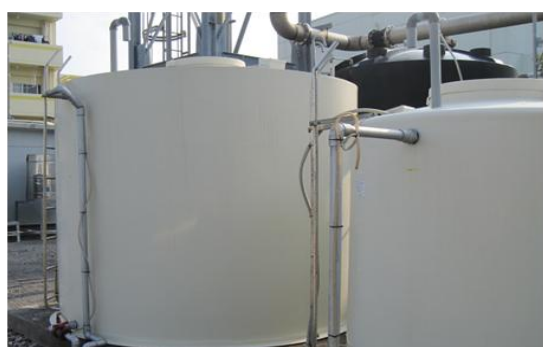
b) 淡水化センターからの濃縮海水貯蔵用タンク
