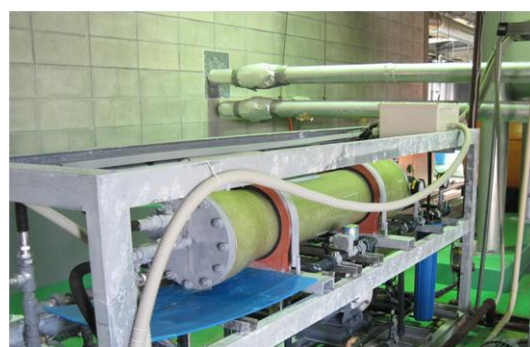
c) 濃縮海水をさらに濃縮するための逆浸透設備
