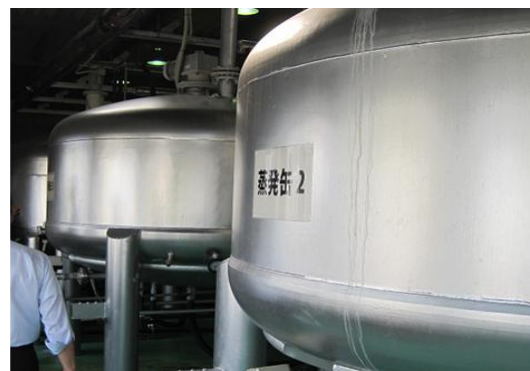
e) 65℃の低温蒸発可能な濃縮方法により10%の濃縮海水を36%まで濃縮する蒸発缶
