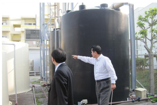
d) 逆浸透設備により作られた高濃縮海水を貯蔵するタンク。蒸発缶に送水する。
