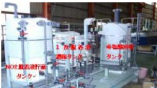
図 4.2-6 無水塩化リチウム生産の処理タンク写真 20
