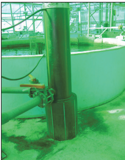
写真 7-3 地下水の汲み上げ装置
