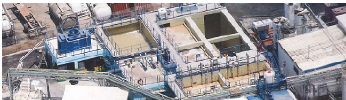
写真 3-5 海水の飲料水製造プラント
