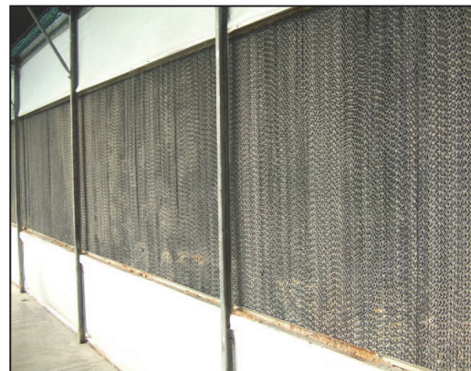
写真 5-2 水冷式の冷氣送風壁
