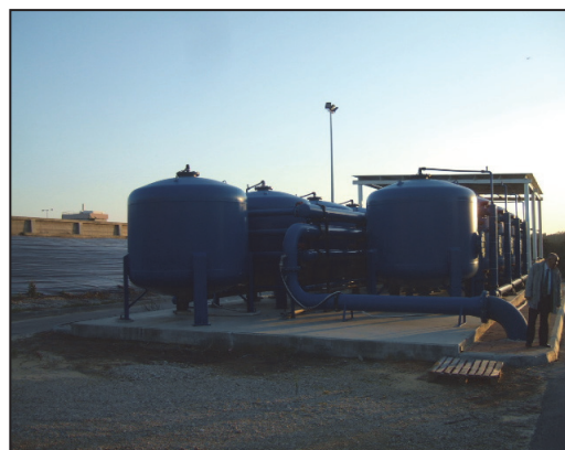
写真 4-5 最終濾過装置
