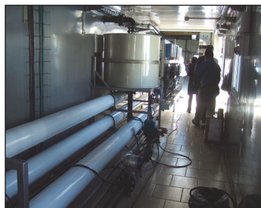
写真 3-4 海水の淡水化プラント
