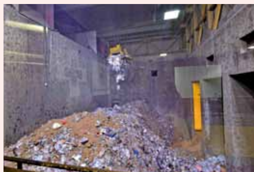
クレーンを遠隔操作し、ごみを溶融炉に投入
