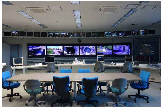
図4.2.3-5 排水機場操作室
