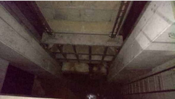
図4.4.3-14 流入遮断ゲート状況
