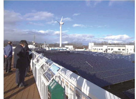
図 2.1.3-1 FREA 実証フィールド（太陽光発電設備と風力発電設備）
