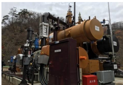
バイナリー発電設備
