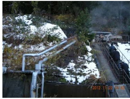
集配湯設備・給湯管
