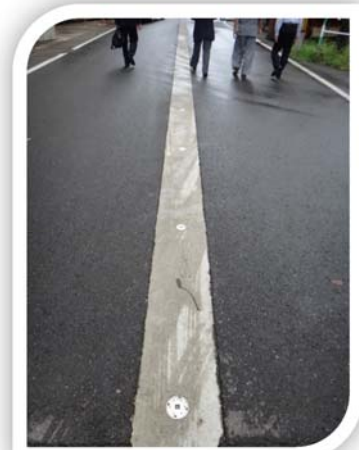
道路融雪施設
