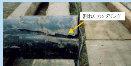
図6 フープストレスによる割れ
