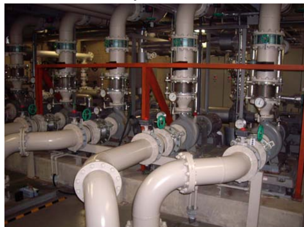
エムウェーブ地下の機械室
