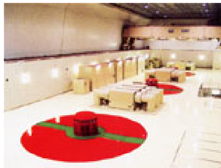
地下発電所内 TEPCO ホームページより掲載 http://www.tepcokinugawa.com/imaichi.html
