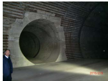
取水施設管渠
