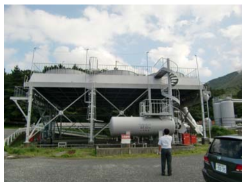
バイナリー発電設備
