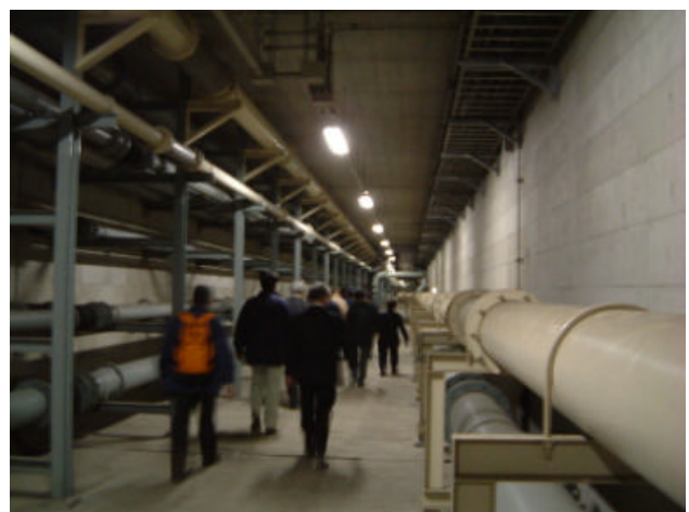
管廊内配管類
