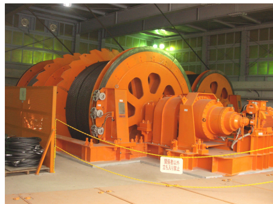
写真1 主立坑巻上設備
