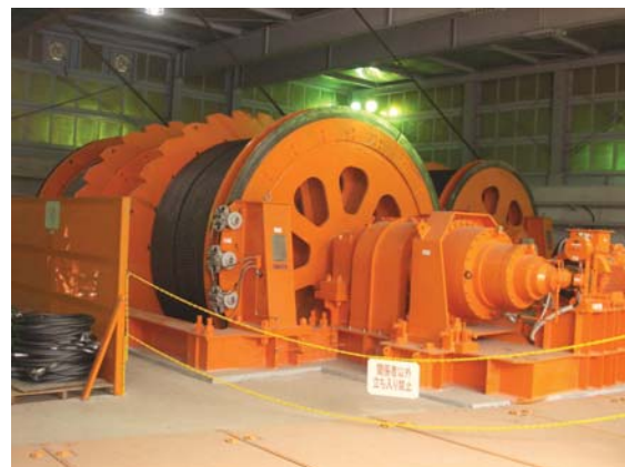
写真1 主立坑巻上設備
