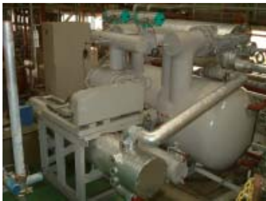
写真 3.3.4-1 新型吸着冷凍機 正面
