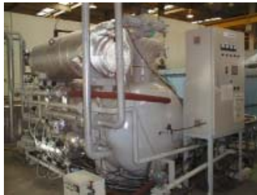
写真 3.3.4-2 新型吸着冷凍機 背面
