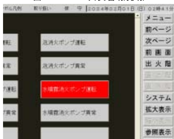
図 3.2.5-8 消火ポンプ表示画面
