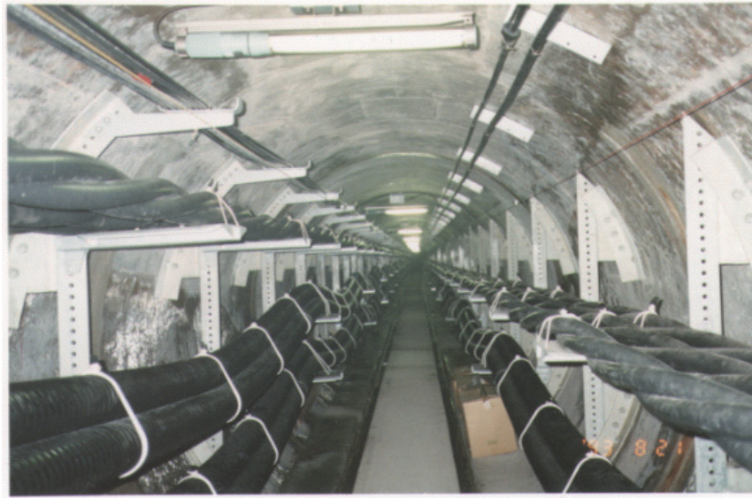
図 3.2.2-3 地下ケーブル用洞道
