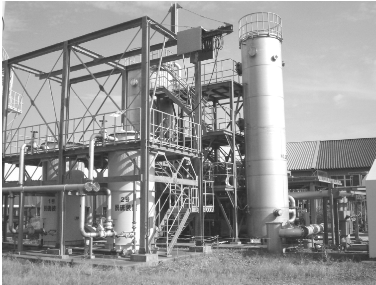
図.3-1-2 吸収塔（後方）の例（金沢市臨海水質管理センター） （吸収液:浄化水、塔内には充填物を入れている。前方は脱硫塔）
