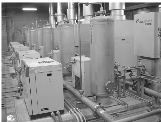
図.2-1-13 マイクロガスタービン発電機
