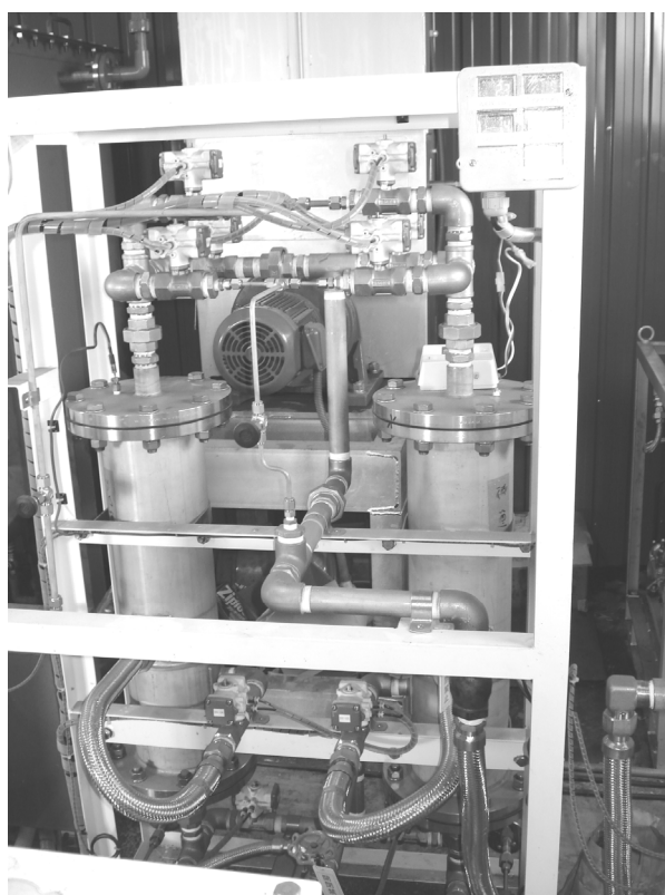
図.3-1-5 減圧再生方式の PSA (細澤牧場設置)
