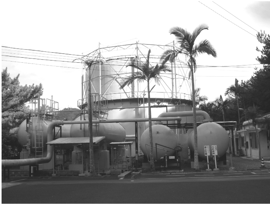
図.4-1-25 名瀬工場タンク類 (前左側) 原料貯蔵タンク、(前右側) サージ (バッファー) タンク、(後方) ガスホルダー
