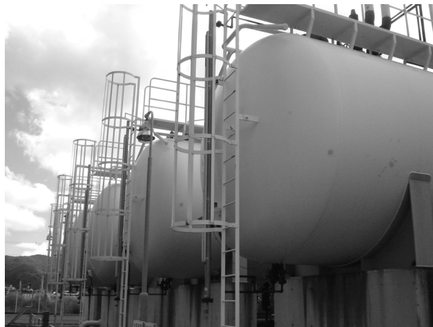
図.4-1-26 奄美大島エルピーガス協同組合の貯蔵タンク
