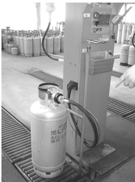
図.4-1-27 LP ガスボンベ充填機
