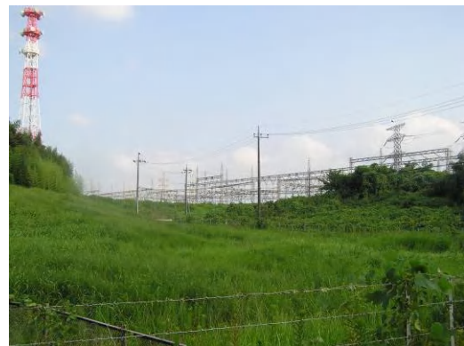
図 2.2-3 新京葉変電所
