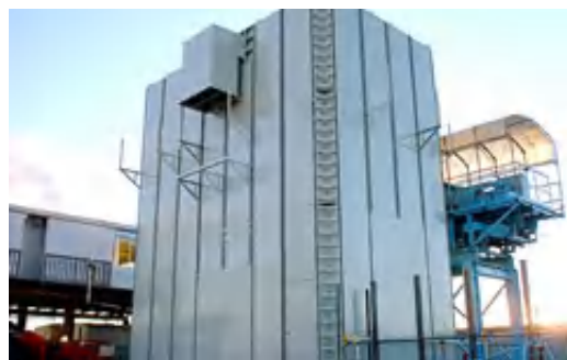
写真 5.2.2-4 超低周波用防音ハウス例
