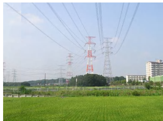
図 2.2-5 新京葉変電所からの架空送電線
