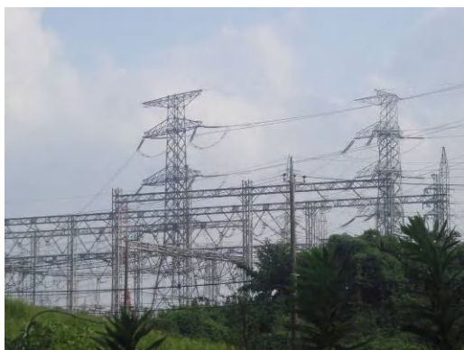
図 2.2-4 新京葉変電所
