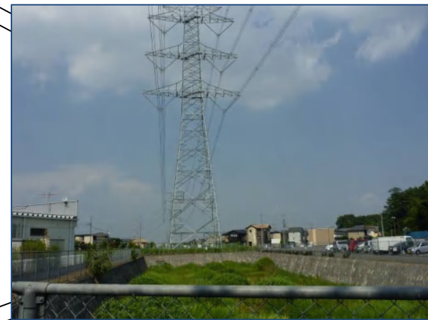
架空線敷設地域の事例
