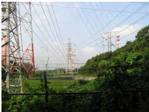
図 2.2-2 新京葉変電所
